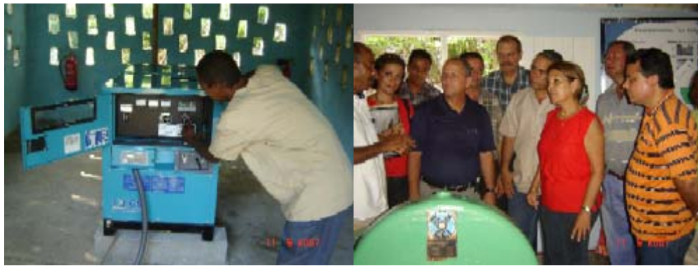
A LA IZQUIERDA PLANTA DIESEL INSTALADA COMO SOPORTE DE EMERGENCIA AL SISTEMA HIDROELECTRICO, A LA DERECHA LA MINISTRA EN LA CASA DE MAQUINA DE LA HIDROELECTRICA.
