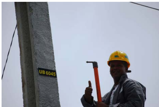
CRUCIAL MOMENTO EN QUE EL TRABAJADOR DE LA EMPRESA ELECTRICA CONECTA LA ELECTRICIDAD A LA COMUNIDAD DE JOVA
